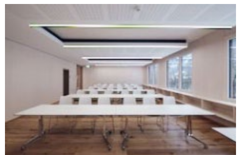
Durch die Akustikdecke zum Kühlen und Heizen wird der Geräuschpegel in den Büros niedrig gehalten.
